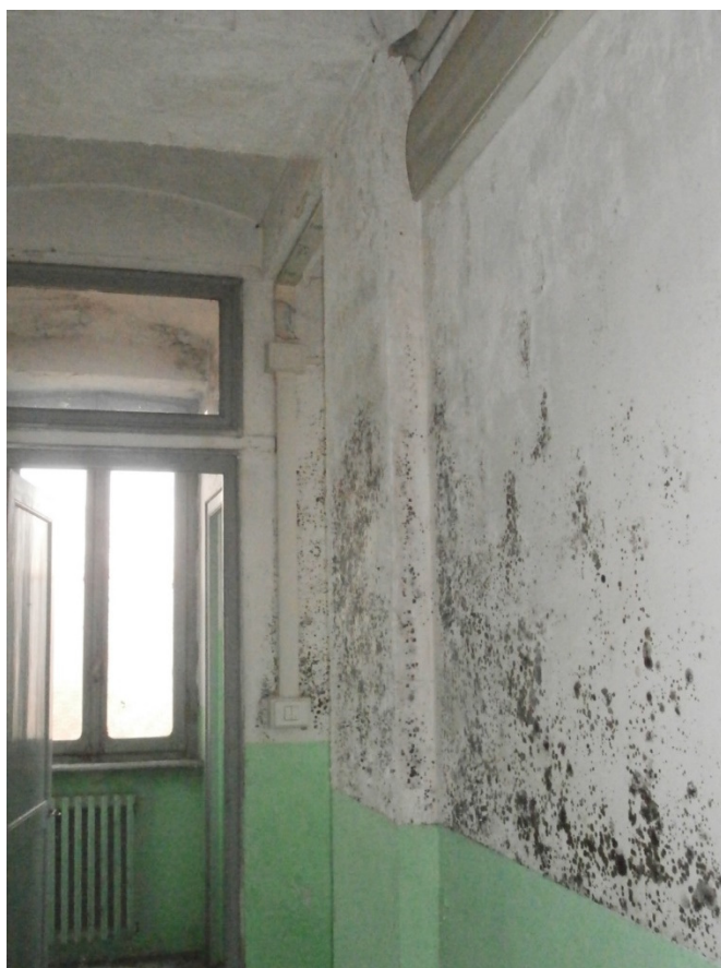
Danni dovuti alla perdita del 2013
