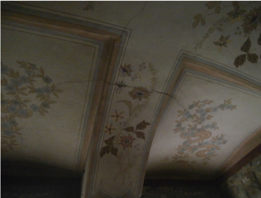
Lesioni delle volta di piano terra
