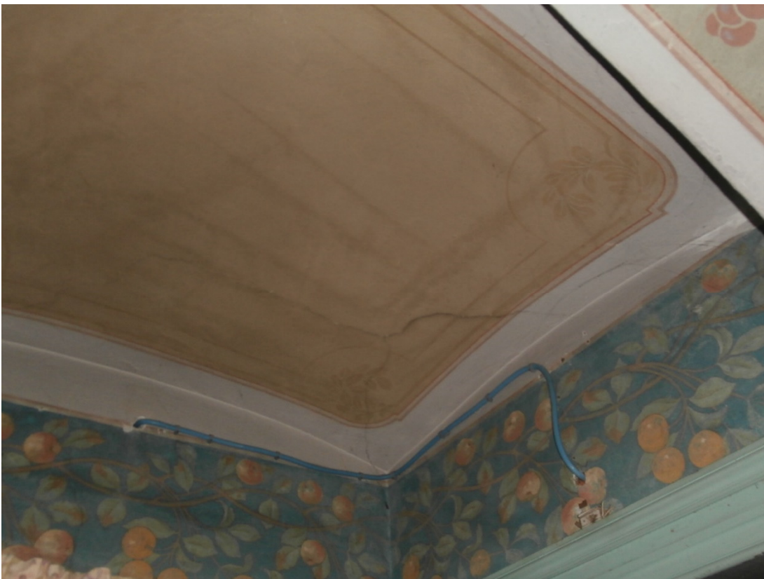
Lesioni delle volta di piano primo
