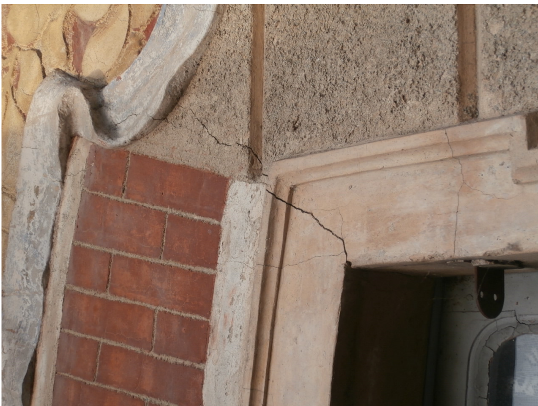
Lesioni sulla facciata sud
