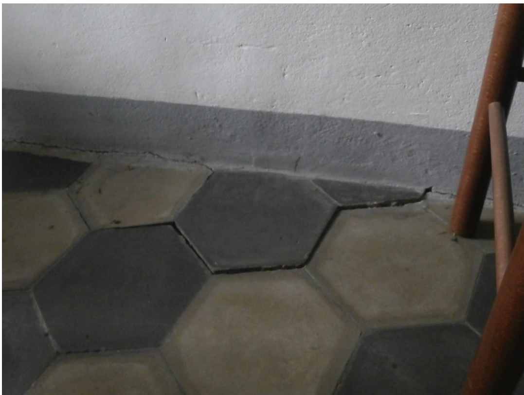
Distacco dei pavimenti
